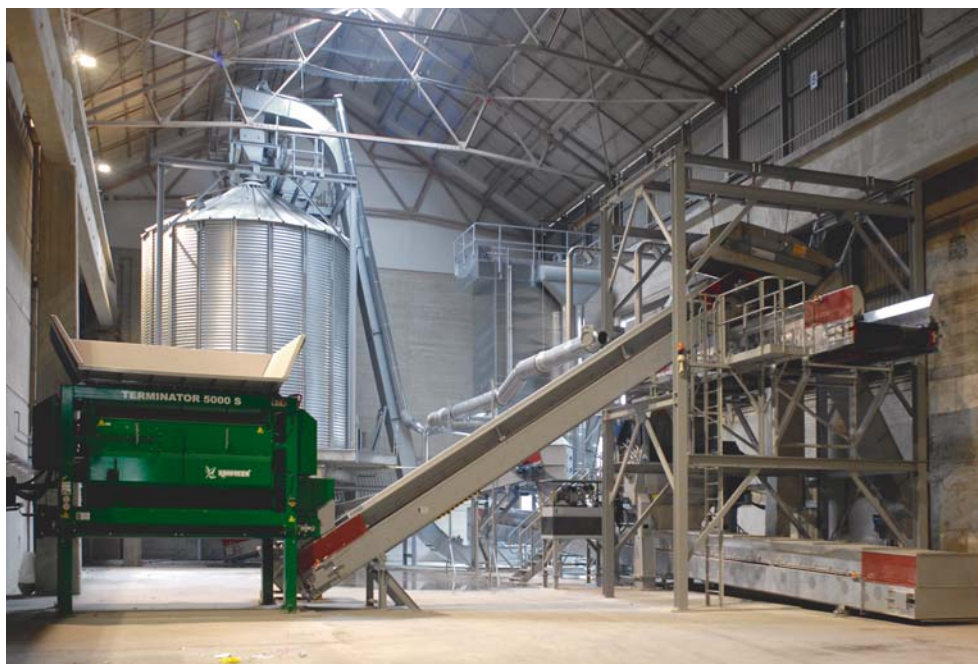
Kunststoffaufbereitungsanlage ABRESTO AG in Wildegg
