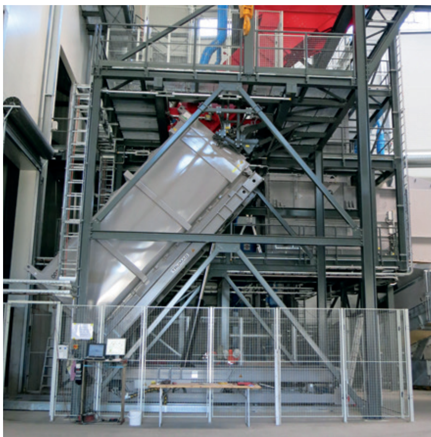
Installation moderne à Hinwil – Conteneur GETAG
