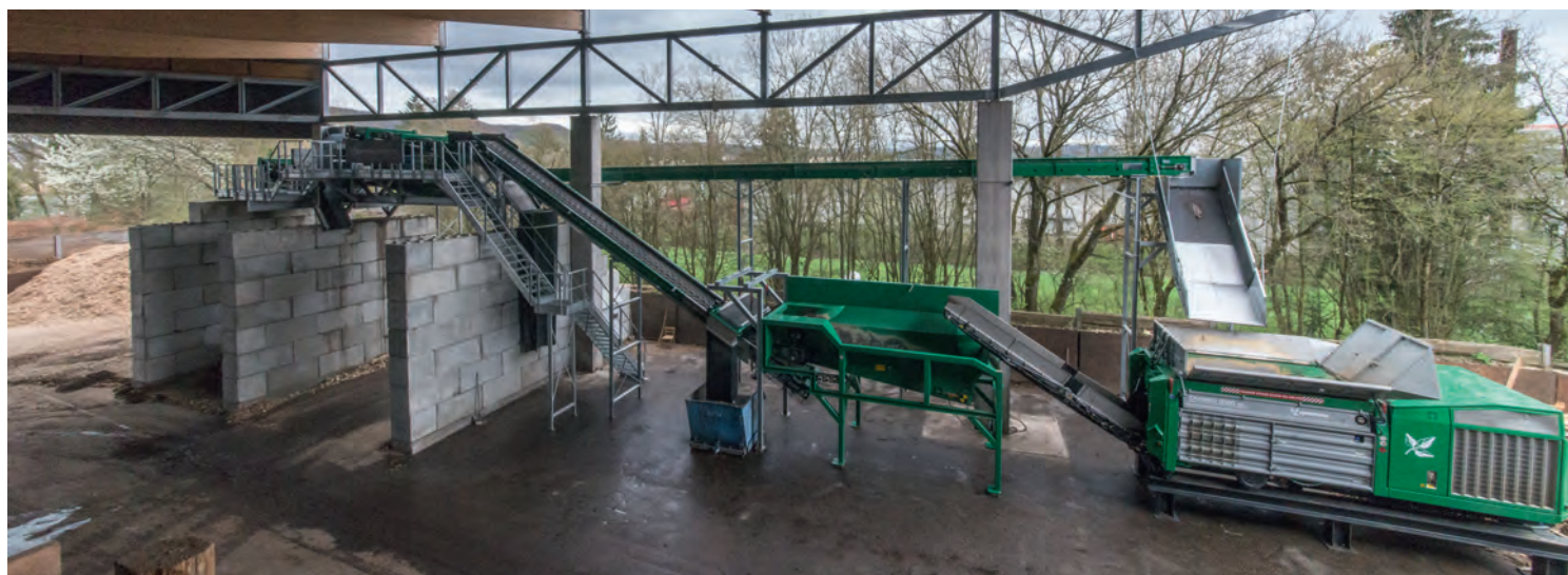
Installation de recyclage de bois: Crambo avec bouche de chargement et installation de tamis à étoiles à 3 fractions
